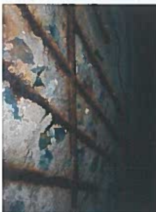
Obrážená výžul v podhledu monolitické železobetonové desky
