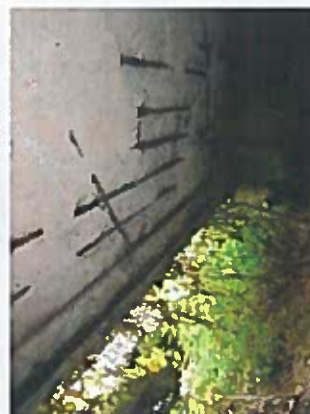
Obrážená výžul v podhledu monolitické železobetonové desky na levé straně mostu
