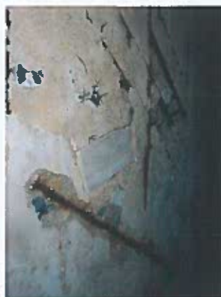
Obrážená výžul v podhledu monolitické železobetonové desky
